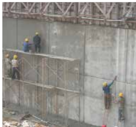
施工现场，工人们使用凯顿公司的T1和T2表面涂刷系统，修补坝面开裂、防水并延长了大坝的耐久性
